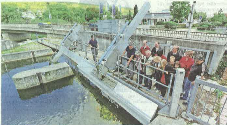
Rechen mit den automatischen Reinigungsharken des Wasserkraftwerks an der Enz in Niefern-Öschelbronn. FOTOS: TILO KELLER
