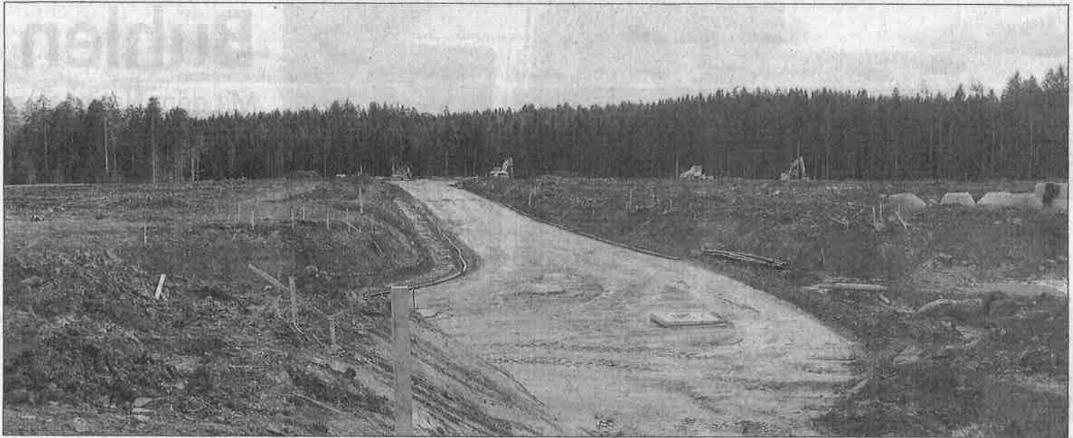
Nach der Waldrodung die Erschließungsarbeiten für das neue Gewerbegebiet Sulzhau. Freudenstadt opferte dafür etliche Hektar bestes Waldgelände.
